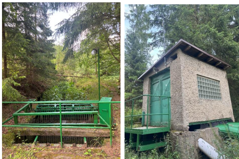
obrázek: MVE „Hraniční rybník“ na území svazku, DP st. č. 403, autor: vlastní
